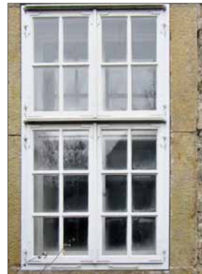
Sanierungsbedürftig: Die historischen Fenster finden sich vor allem im „Slaphus“, einem der ältesten Gebäude des Klosters, und dem Konvent, erbaut um 1750.
