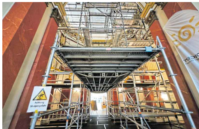
Das Gerüst wiegt allein 28 Tonnen. Die Kellerdecke musste dafür extra abgestützt werden.
