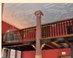
Bobbelage im Kontorraum
