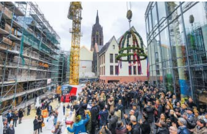
Feierlich: Beim Richtfest bejubelten Hunderte die Restauration von historischen Gebäuden in der Frankfurter Altstadt.
