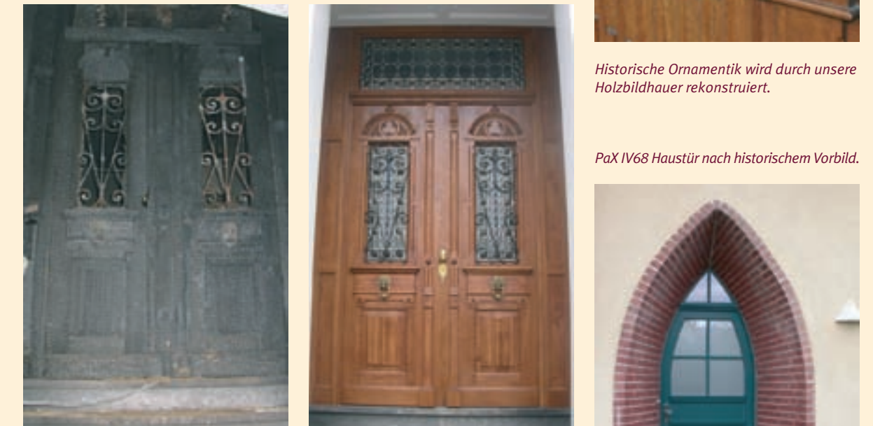
Durch Brand zerstörte Eingangstür.
