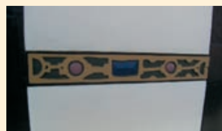
Anstrich der Fachwerkhölzer mit Leinölasur und Leinölfarben, auf den Putzflächen ein mineralischer Anstrich.
