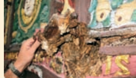
Durch Weißfäule zerstörte Fachwerkschwelle.
