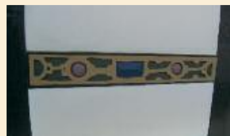
Anstrich der Fachwerkhölzer mit Leinöllasur und Leinölfarben, auf den Putzflächen ein mineralischer Anstrich.
