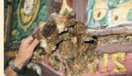
Durch Weißfäule zerstörte Fachwerkschwelle.
