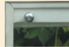
Hutverschraubung als Verschluss in Edelstahl mit D-Profilabdichtung.
