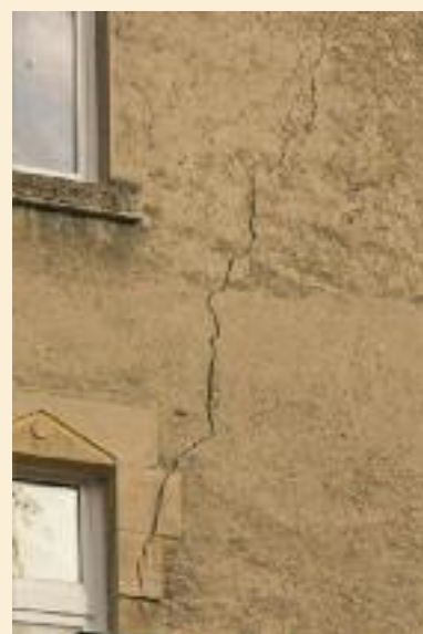
Breit aufklaffender Riss infolge Mauerwerksverspannungen und Dachschub.
