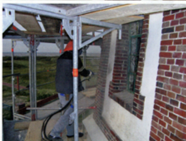
Links: Maurermeister Andreas Kramp begutachtet die Schäden am Klinkermauerwerk des Wasserturms
